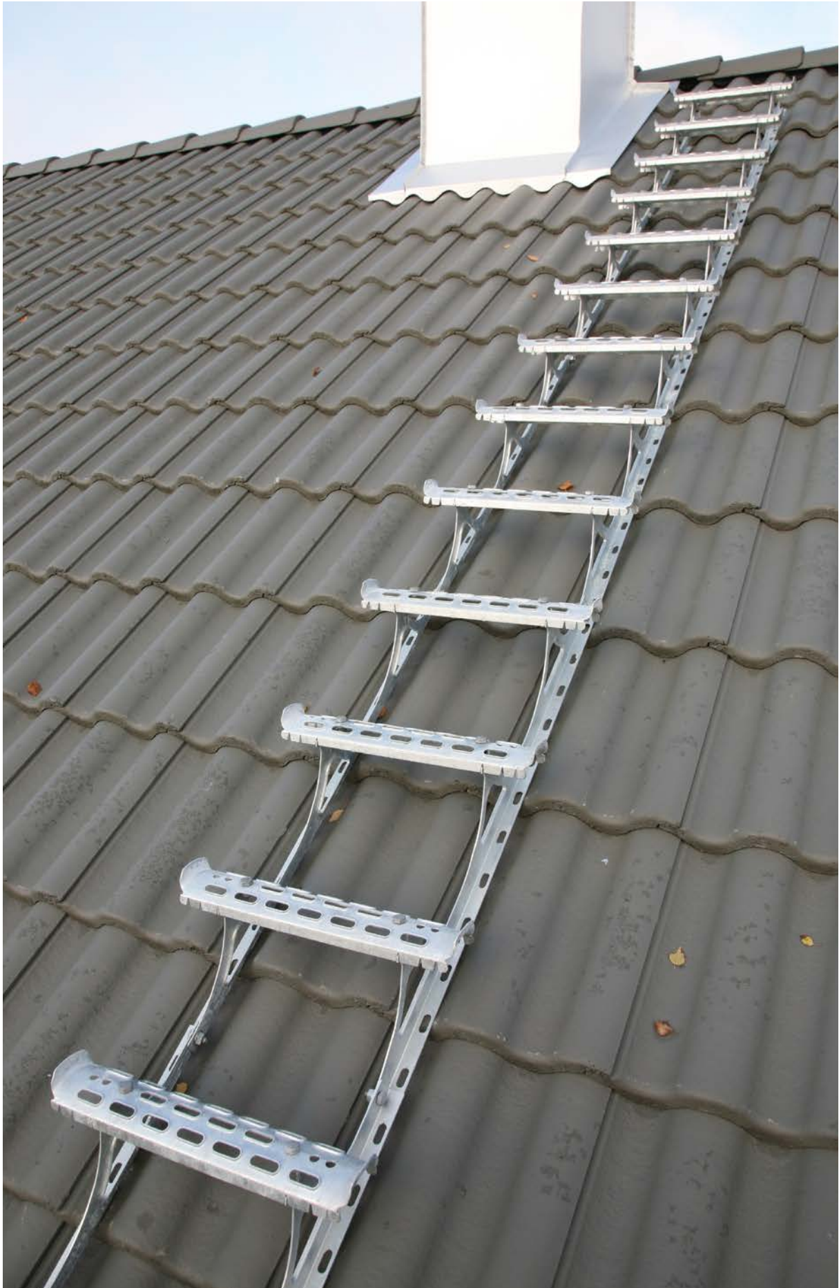
Universalstige på tak med betongtakstein.
