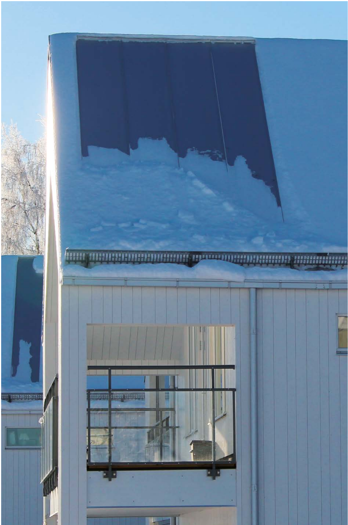
Snøfanger i profilrist med isstopper montert på båndtekket tak.
