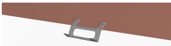
Sklisikring der takrenne mangler.
