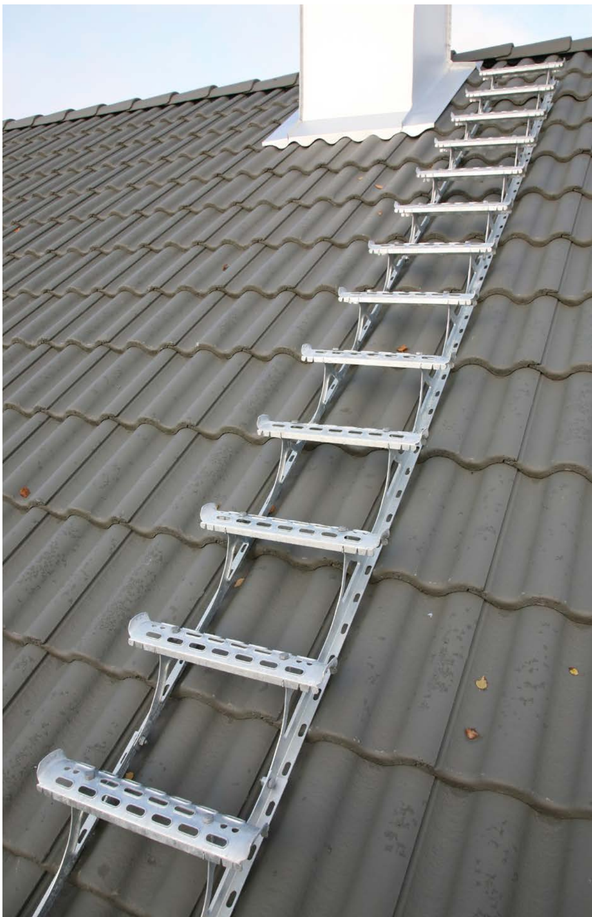
Universalstige på tak med betongtakstein.
